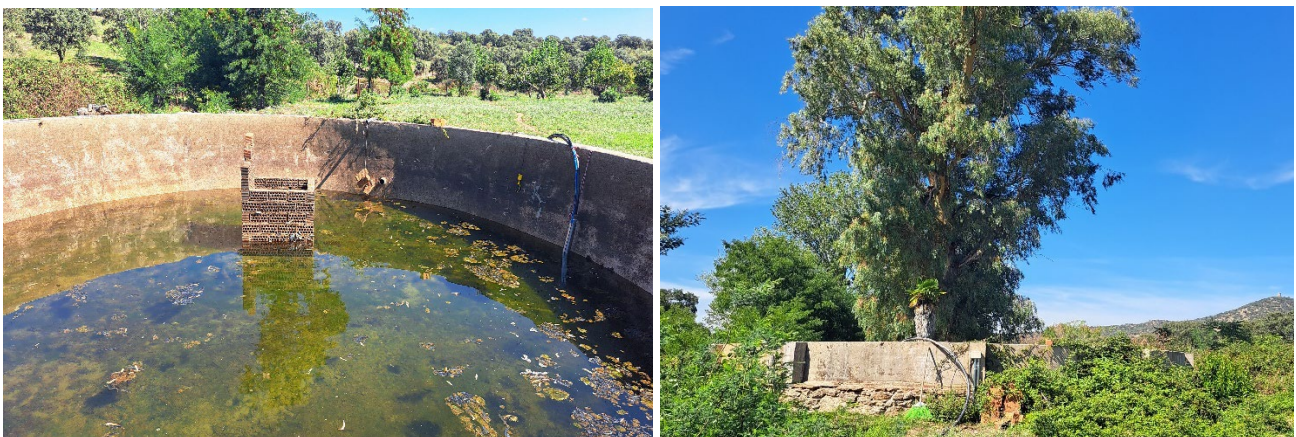
Figura 4. Izda.: Depósito de agua objetivo de la medida, sin sistemas de escape anti ahogamiento para la fauna; dcha.: ubicación del depósito de agua objetivo de la medida, al pie del árbol en el que se sitúa el nido de águila imperial ibérica.
